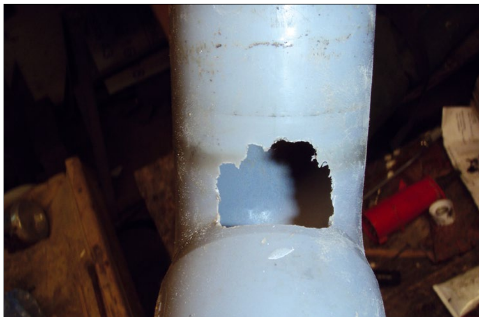
Fot. 6.46. Szkody spowodowane przez szczura – przegryziona rura kanalizacyjna (fot. S. Ignatowicz)
