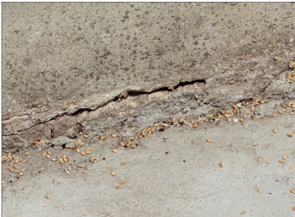
Fot. 4.9. W spękaniach ścian i podłóg gromadzą się resztki ziarna. Stanowią one również kryjówkę dla szkodników (fot. T. Klejdysz)
