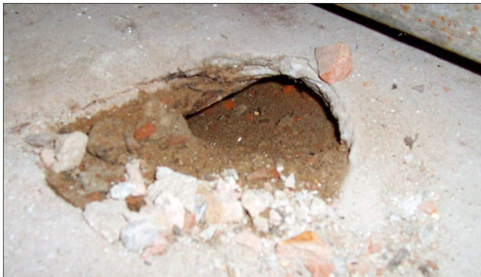
Fot. 7.10. Nora szczura przy fundamencie budynku (fot. S. Ignatowicz)
