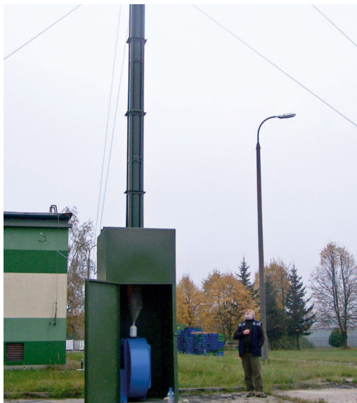
Fot. 18. Wnętrze kabiny aspiratora (A. Bułatowicz)
